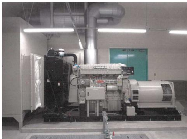
Рисунок 5. Обслуживание резервной генераторной установки в госпитале Сендай
