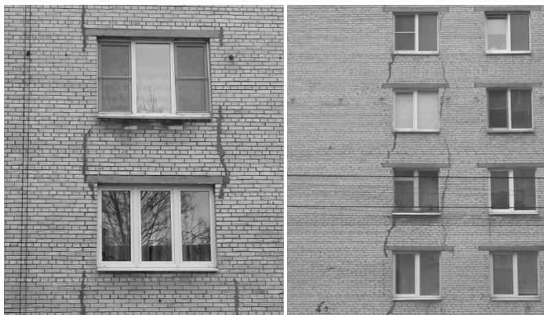
Рис. 4. Появление недопустимых трещин у исследуемого административно-хозяйственного здания
